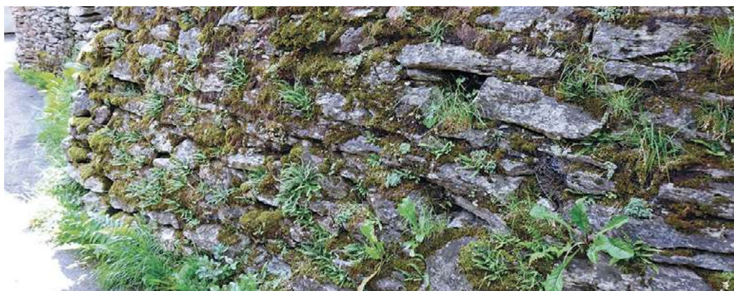
Figura 45. Muro di un'abitazione a Cagnoletti, rivolto a Nord, colonizzato da essenze di ambienti sciafli.
