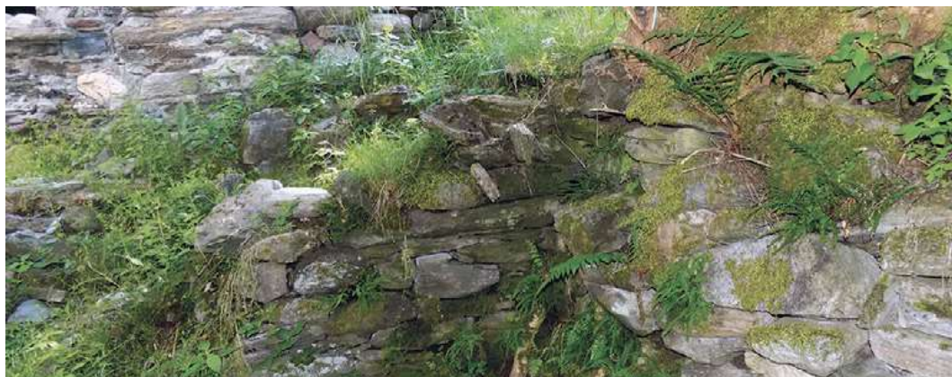
Figura 43. Muro di sostegno all'interno dell'abitato di Melirolo. La posizione riparata e umida consente la crescita di ben tre specie di felci: l'Asplenio tricomane, la Felcetta fragile e la Felce maschio.
