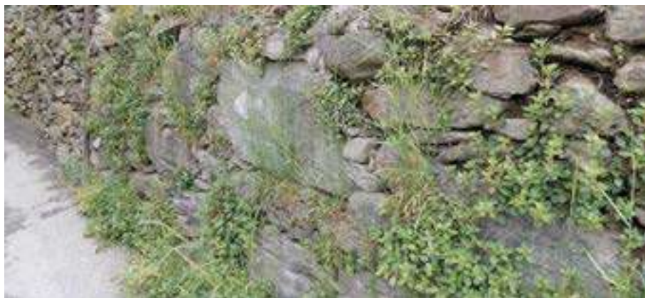
Figura 6. Il muretto è colonizzato da piante tipiche delle rupi e dei muri caldi, come il Ciomolino comune e la Vetriola minore.
