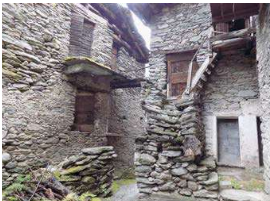
Figura 47. A Spriana due rampe di scale di accesso ai piani superiori di due abitazioni separate dalla strada hanno origine da un unico sostegno.
