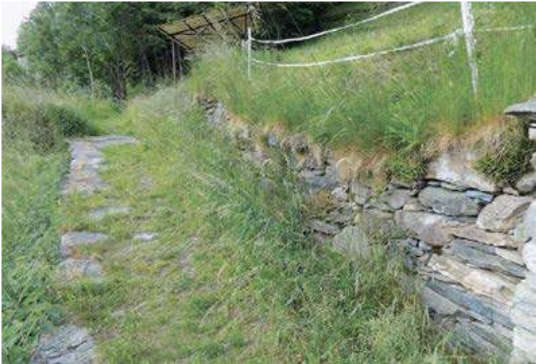
Figura 13. Un muretto a monte protegge la mulattiera a Cristini. Del selciato sono rimaste le grosse pietre sul lato esterno della mulattiera.
