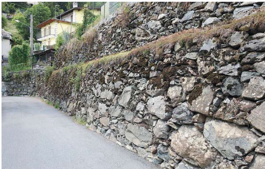
Figura 57. Muro che sovrasta via Franco Sapietro a Chiesa in Valmalenco colonizzata da specie legate ad ambienti aridi e caldi.
