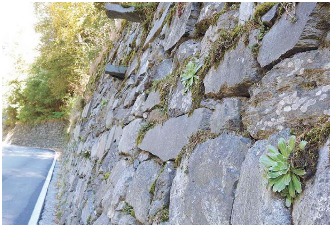
Figura 55. Muro di sostegno del versante a difesa della strada provinciale n. 15, al km 11, colonizzata da essenze rupicole di quota.
