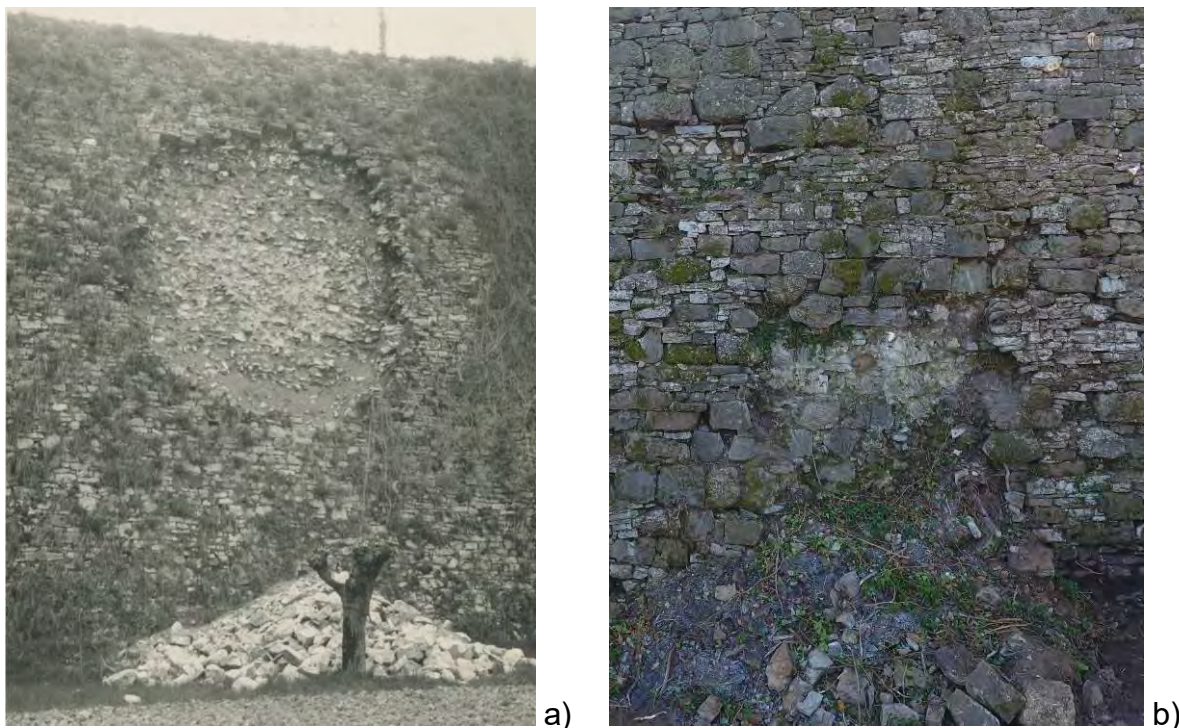
4: Crolli del paramento rilevati presso Sant'Agostino nel 1951 15 (a) e dissesti attuali lungo il baluardo di Valverde (b), Orobicambiente OdV) a confronto.
