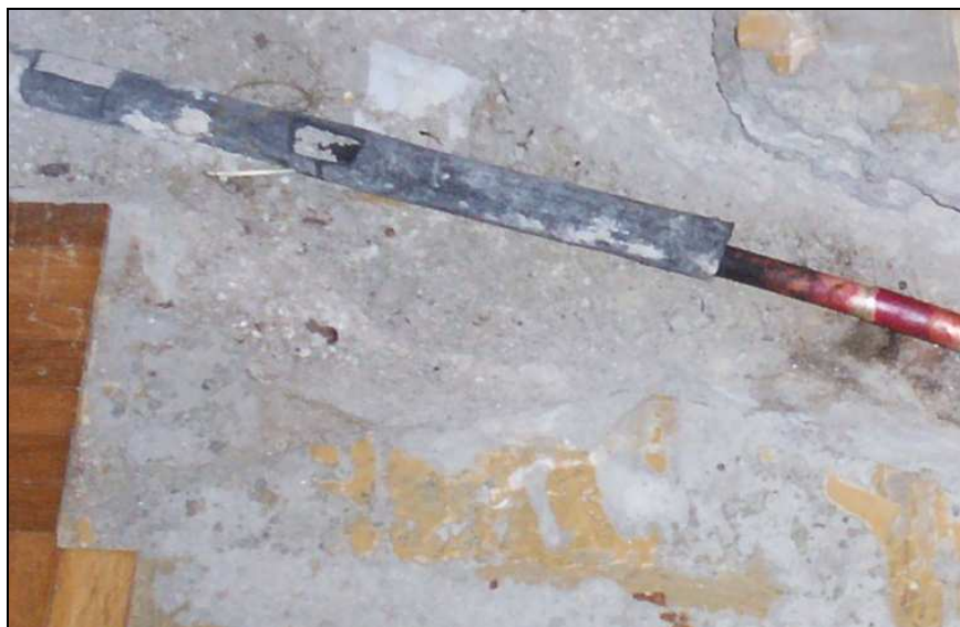
Figura 6. Particolare: tubo annegato nel massetto del pavimento
