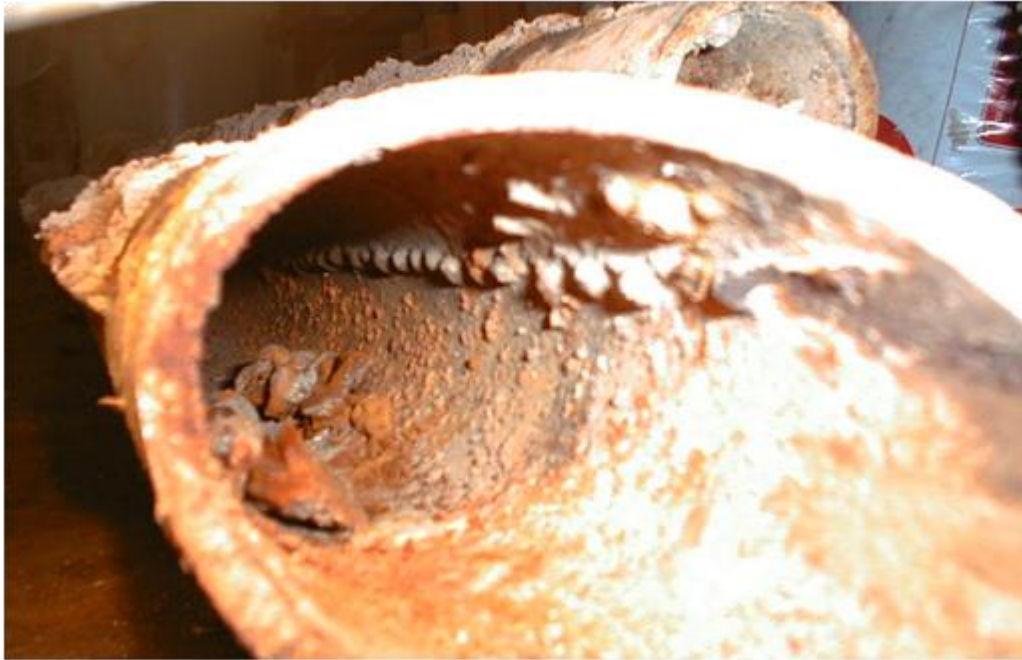
Fig. 4: tubercoli in acquedotto dopo lunga vita di servizio [22]
