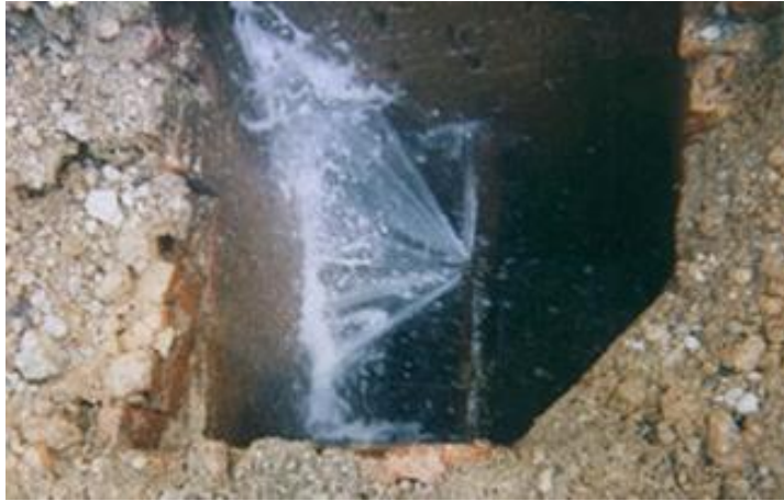
Fig. 2: perdita di acqua in seguito a perforazione di una tubazione
