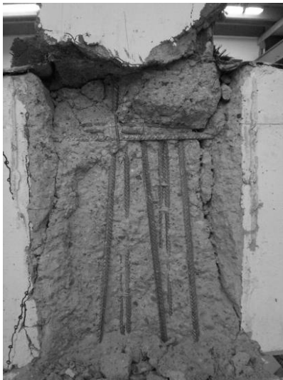
Fig.13 – Danneggiamento all'interno del nodo dopo la rimozione della camicia in HPFRC
