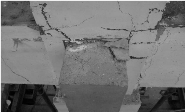
Figura 12 – Quadro fessurativo del nodo nella parte posteriore
