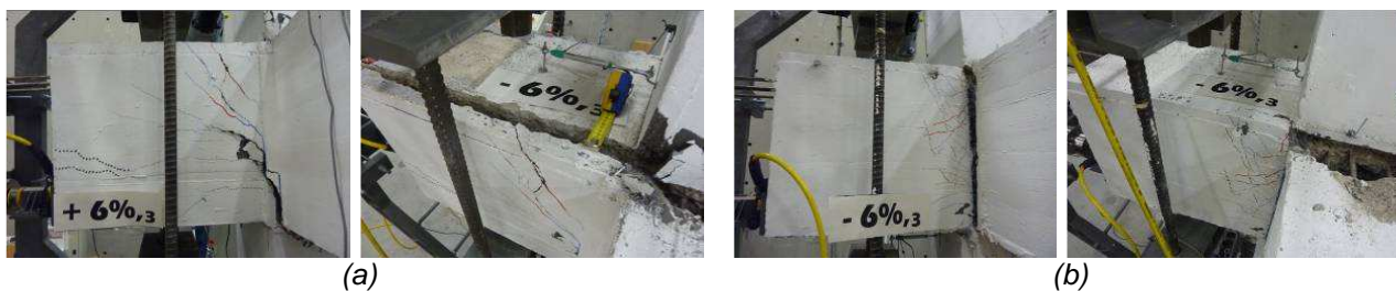
Figura 9. Danneggiamento della faccia interna dei nodi alla fine delle prove: (a) Campione RCJ1; (b) Campione RCJ2
