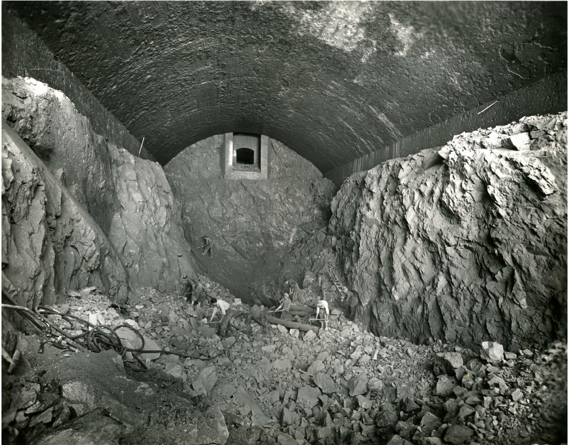
Lavori di scavo all'interno della centrale in caverna sottostante il Pantano d'Avio inizio anni Cinquanta
