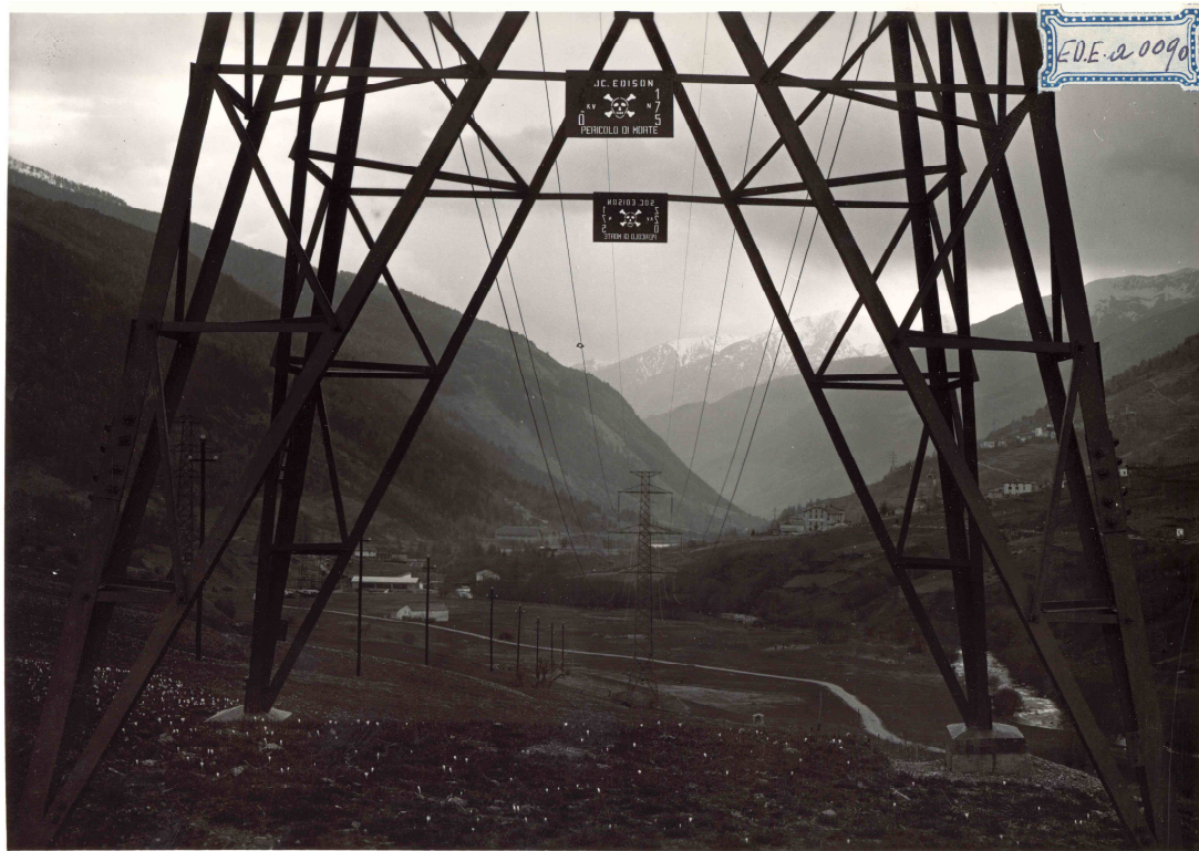
Passaggio di elettrodotti in alta Valle Camonica
