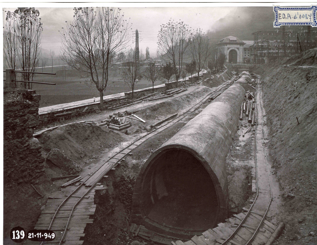
Società Edison: lavori di costruzione del canale Sonico- Cedegolo nei pressi della centrale di Sonico, 1949
