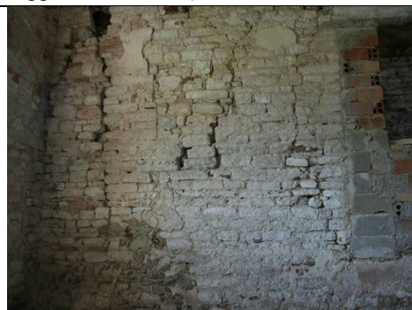
Livello 1: forte disomogeneità dovuta a trasformazioni della fabbrica, presenza di effetti di degrado e di dissesto pregresso
