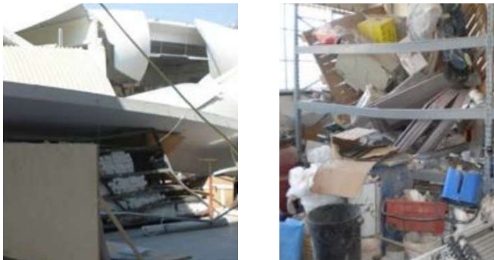
Figura 12 Esempi di danneggiamento del contenuto a seguito del collasso della copertura o delle scaffalature disposte all'interno di magazzini [G.L.A.S.C. 2012]
