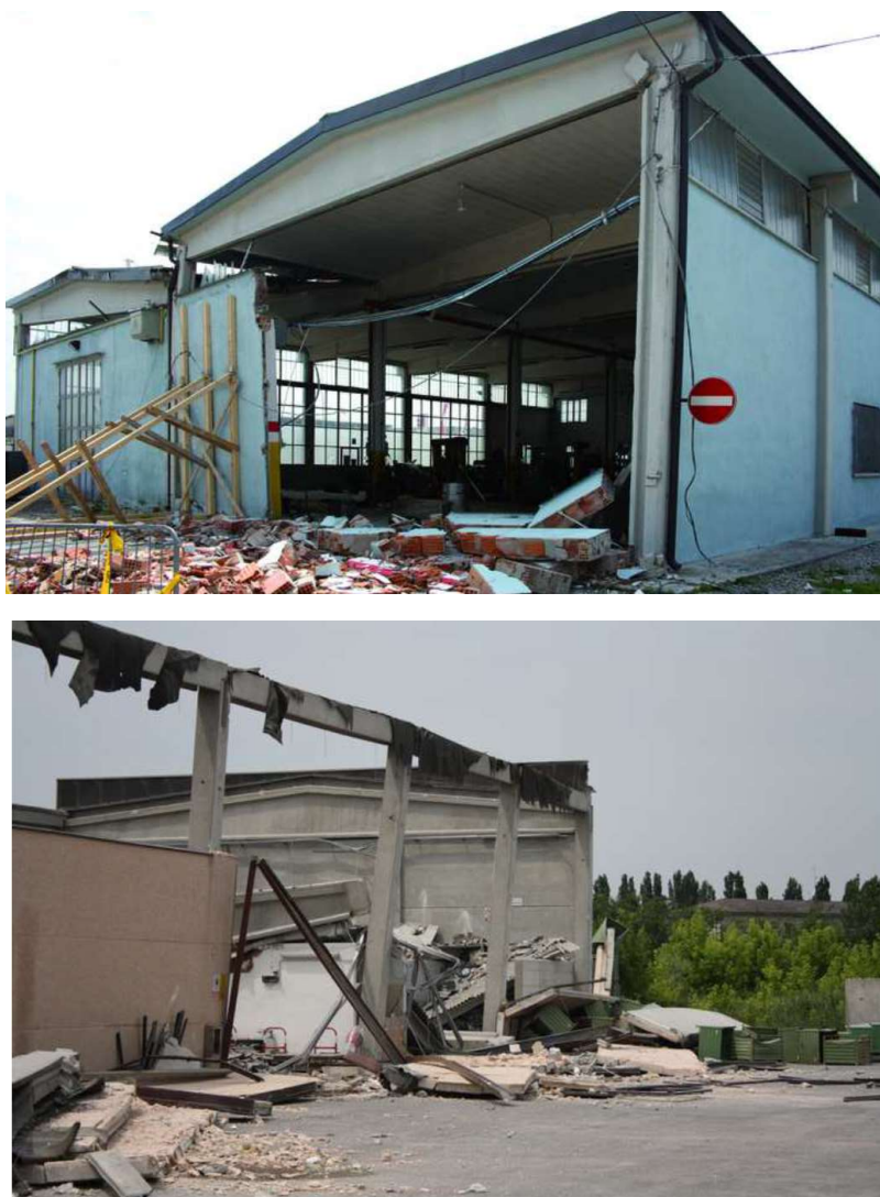
Figura 3 Effetti del sisma in Emilia-Romagna su alcune strutture prefabbricate [Belleri et al. 2015]
