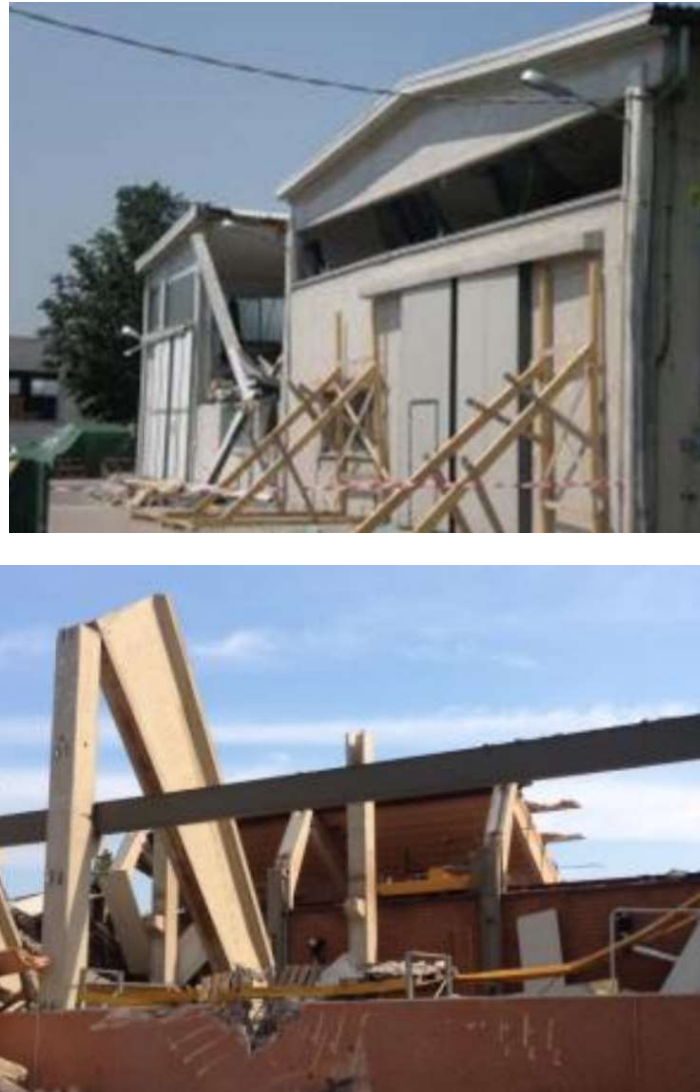
Figura 9 Alcuni esempi di collasso della copertura per perdita d'appoggio degli elementi costituenti [G.L.A.S.C. 2012]
