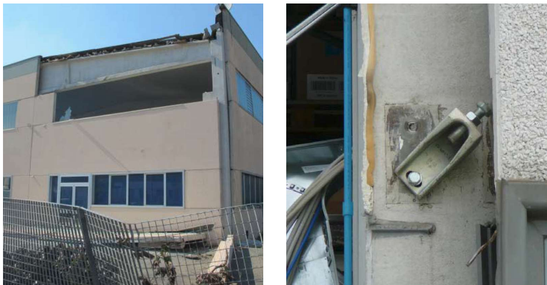
Figura 11 Collasso del pannello di chiusura orizzontale e della relativa connessione [G.L.A.S.C. 2012]
