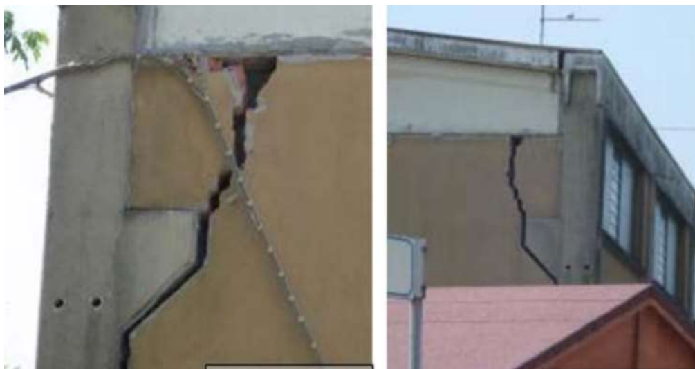
Figura 10 Esempi di fessurazione diagonale nel tamponamento ed interazione tamponamento – struttura [G.L.A.S.C. 2012]
