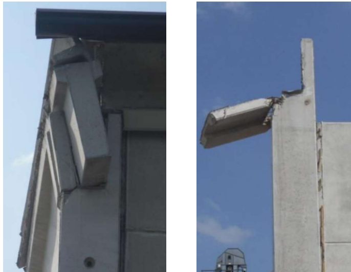
Figura 8 Esempi di danneggiamento e collasso delle forcelle in calcestruzzo armato aventi il compito di garantire stabilità alla trave [G.L.A.S.C. 2012]
