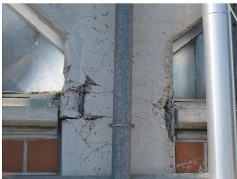
Figura 7 Esempi di danneggiamento dovuti all'irregolarità in altezza della struttura [G.L.A.S.C. 2012]
