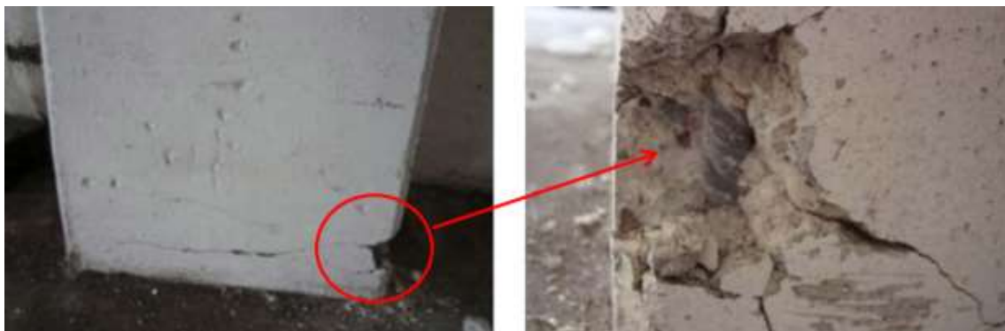
Figura 6 Esempi di fessurazione ed espulsione di copriferro in seguito alla formazione di una cerniera plastica alla base del pilastro [G.L.A.S.C. 2012]
