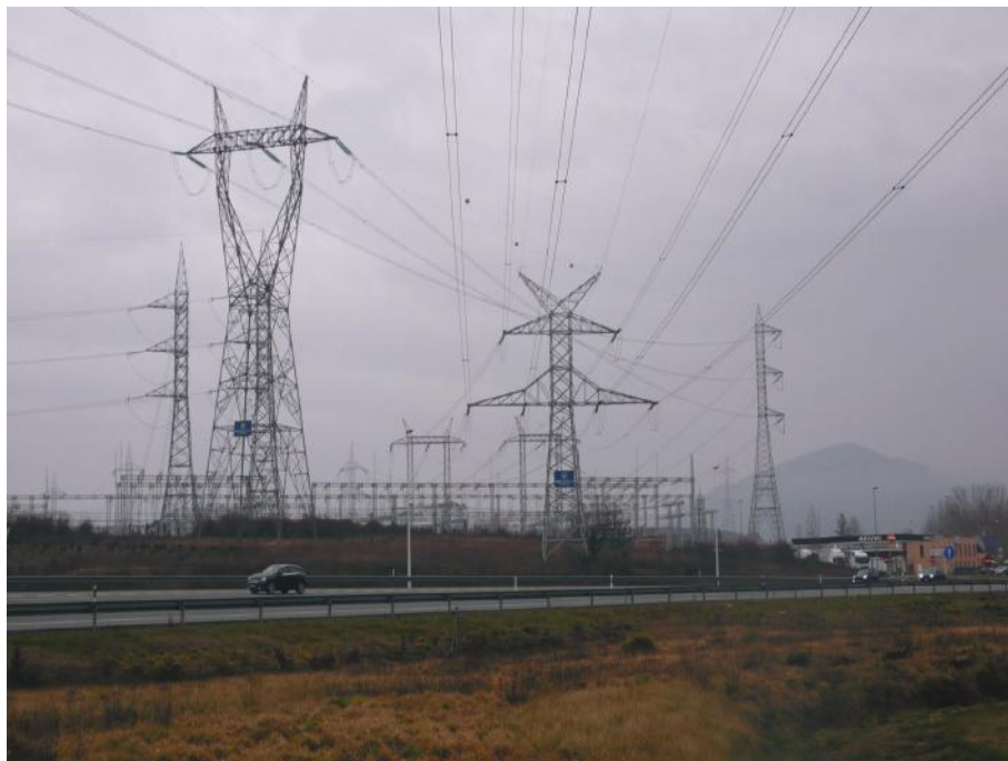
Figura 18. Redes de alta tensión en El Bierzo. Fuente: Fotografía del autor.
