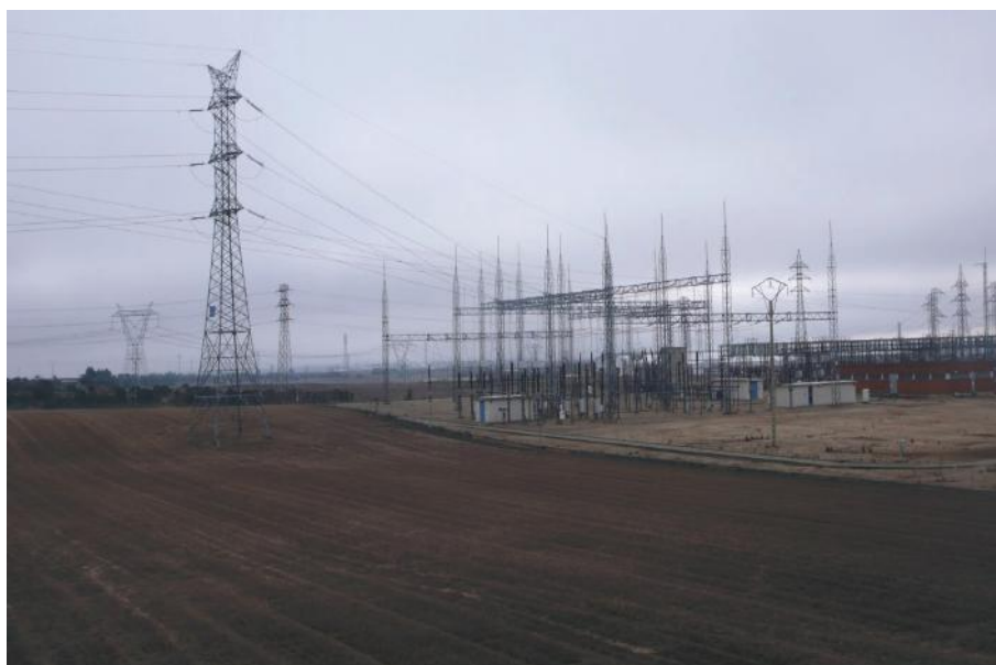
Figura 19. Redes de alta tensión y parque de transformación en la provincia de Valladolid. Fuente: Fotografía del autor.
