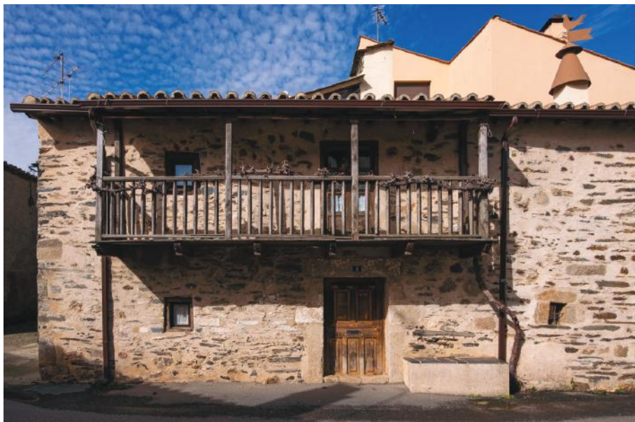
Figura 3. Muros de piedra vista en una rehabilitación en Alcañices. Fuente: Fotografía de C. Hernández.
