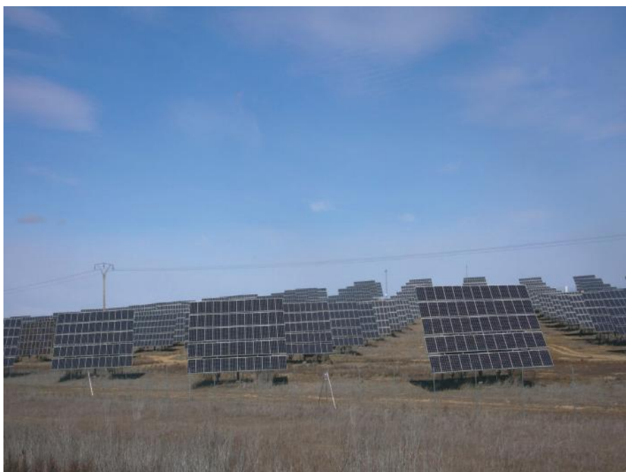
Figura 16. Parque fotovoltaico, próximo a Tordesillas. Fuente: Fotografía del autor.
