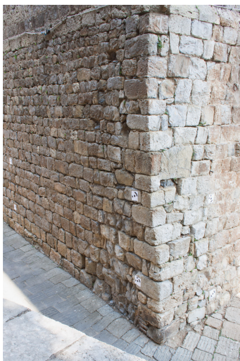
Fig. 7. Lo spigolo nord-occidentale, con le lesioni che ne denotano lo schiacciamento (foto di A. Ghezzi).
